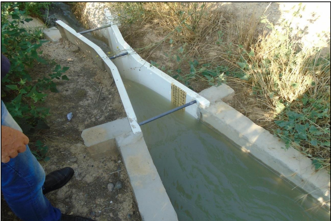
Figura 8. Aforador Parshall para control de los caudales de riego en las parcelas regadas a manta a fecha 12/07/2017.
